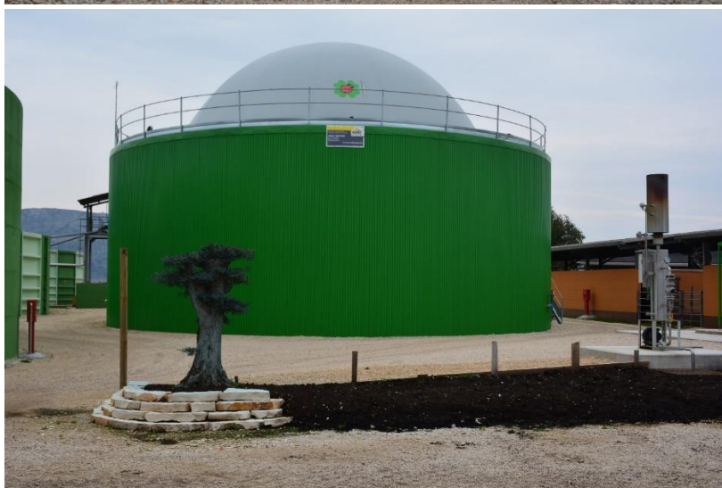
Figura 5: Il sistema MAPS SCADA consente agli operatori presso l'azienda agricola Roana di monitorare e controllare l'intera centrale a biomasse, per mantenerla in condizioni ottimali di funzionamento e massimizzare la quantità di energia generata dagli scarti di allevamento.
