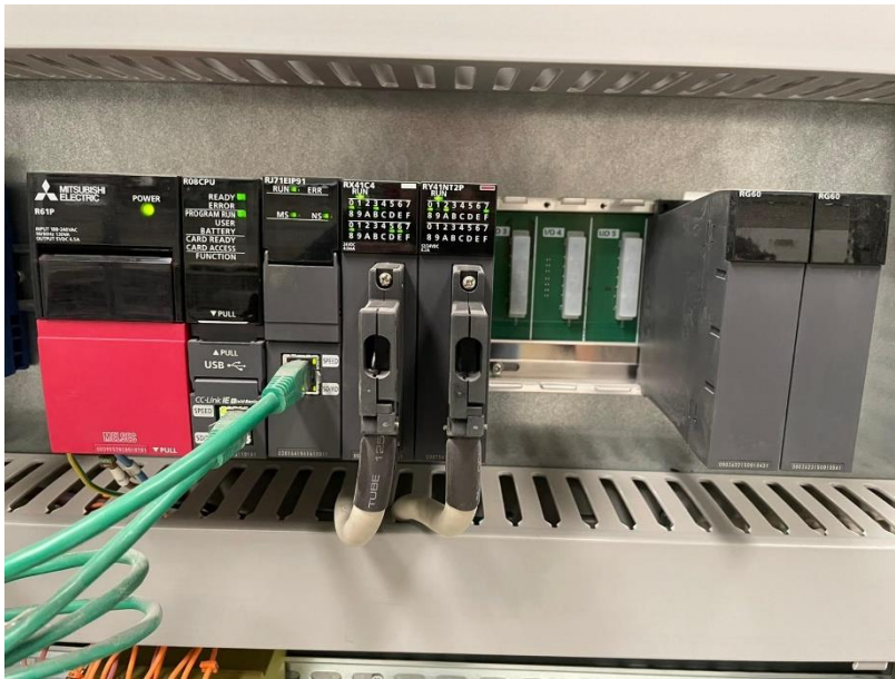
Bild 5: Für die Steuerung der 19 Frequenzumrichter wählte Profile Developments die SPS der iQ-R-Serie von Mitsubishi Electric. [Quelle: Mitsubishi Electric Ireland]
