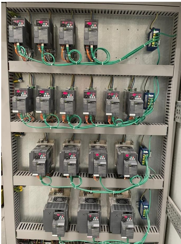
Bild 4: Die neue Türpressanlage wird von 19 Frequenzumrichtern der FR-E-Serie von Mitsubishi Electric angetrieben. [Quelle: Mitsubishi Electric Ireland]
